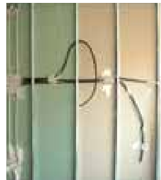
Detalle instalación eléctrica
